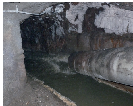
Salida al sistema de túneles de aguas residuales
